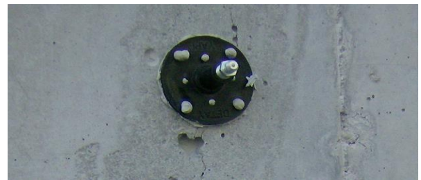
Platzierung des Klebepackers auf dem Riss
